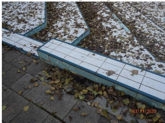
Foto 3 en 4: Verzakking van tegelwerk rondom bassins
