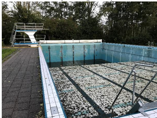
Foto 19: Lamelleafdekking ondiep bad
