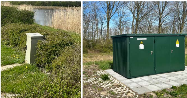
Figuur 2: Trafo en gemeal langs de Zijperlaan
