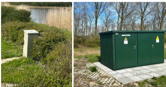
Figuur 2: Trafo en gemeal langs de Zijperlaan
